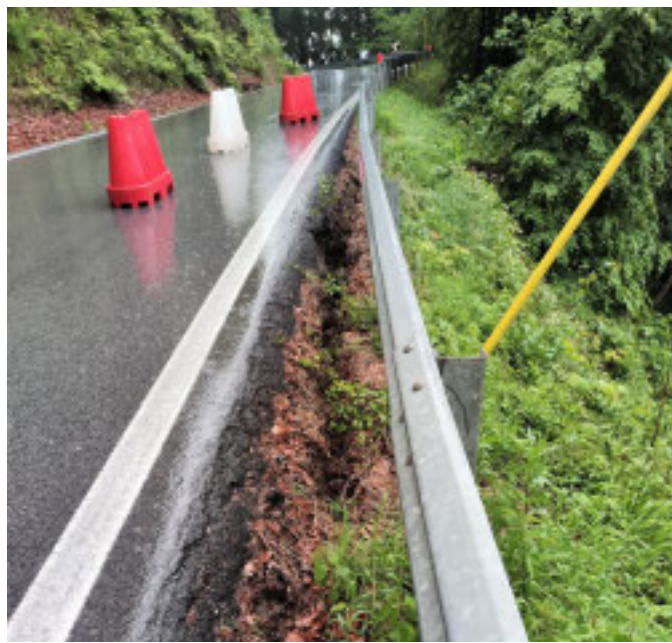
Tratto in frana tra Pagno e Brondello
