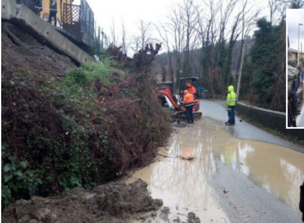
GLI INTERVENTI a Davagna e a Pieve Ligure per liberare le strade dalle frane
