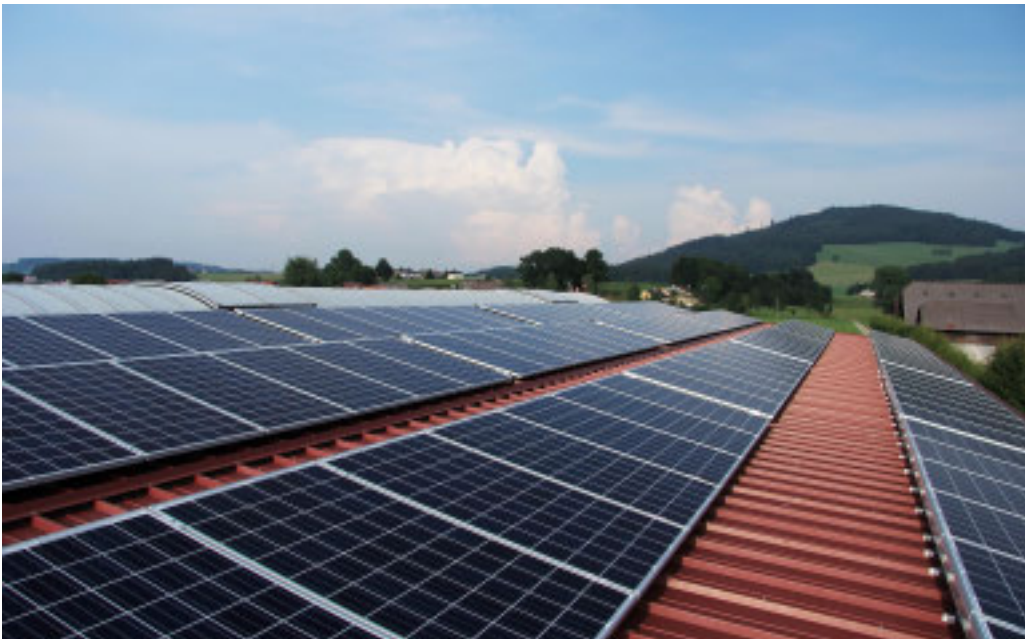
Un impianto fotovoltaico installato su un tetto
