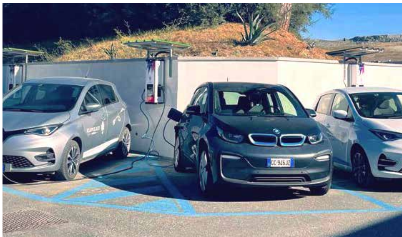
Exe Engineering. Postazioni per ricarica elettrica
