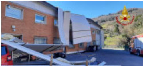
Il disastro compiuto dalle raffiche di vento
